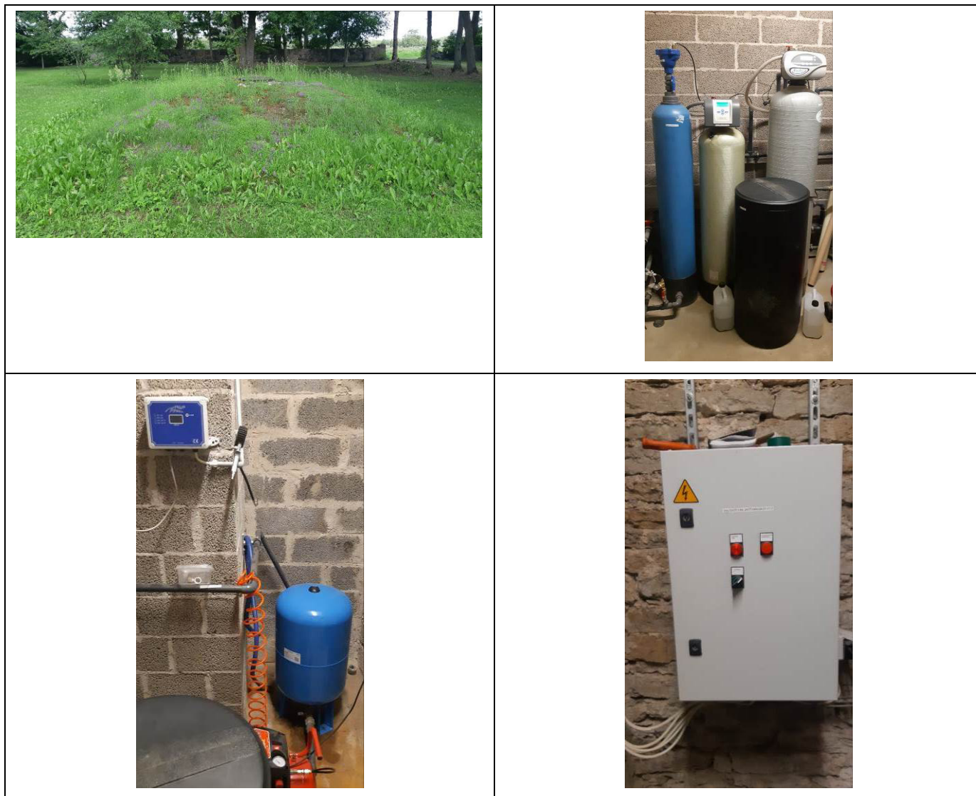
Joonis 14. Vasta küla puurkaev-pumpla (katastri nr 14364) ja veetöötlusjaam. Fotod: OÜ Alkranel 18.07.2024.
