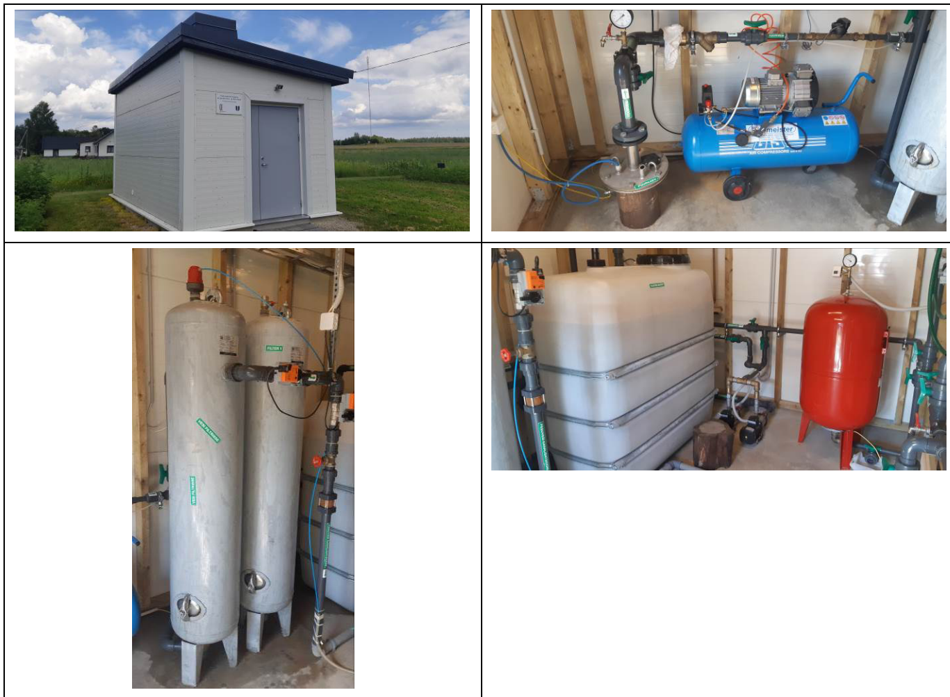
Joonis 13. Pada küla puurkaev-pumpla (katastri nr 52995) ja veetöötlusjaam. Fotod: OÜ Alkranel 18.07.2024.
