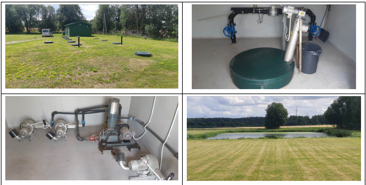
Joonis 12. Viru-Nigula aleviku reoveepuhasti. Fotod: OÜ Alkranel 18.07.2024.
