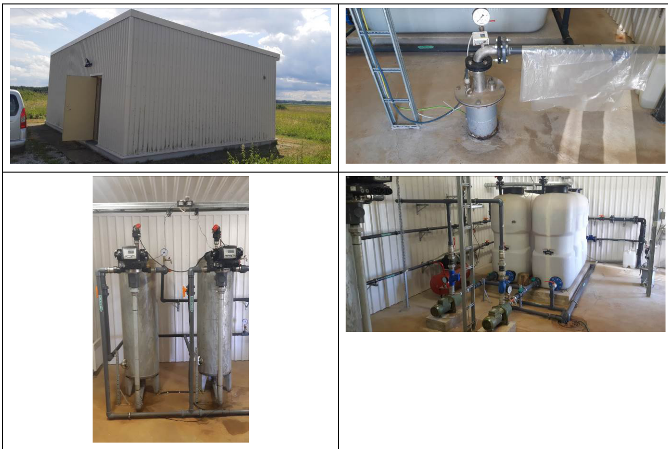
Joonis 8. Rannu küla puurkaev (katastri nr 2423) ning veetöotlusjaam. Fotod: OÜ Alkranel 18.07.2024.
