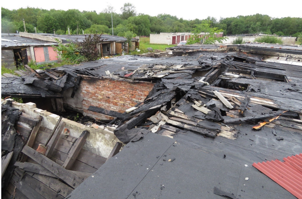
Фото 3 Последствия пожара, распространившегося от пустующих гаражных боксов на те, что были в использовании (источник: Восточный спасательный центр)
